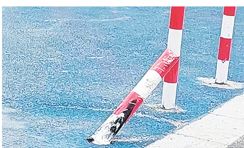
解放南路与樟江东路交叉口向南约5米路东，人行道隔离桩损坏。
