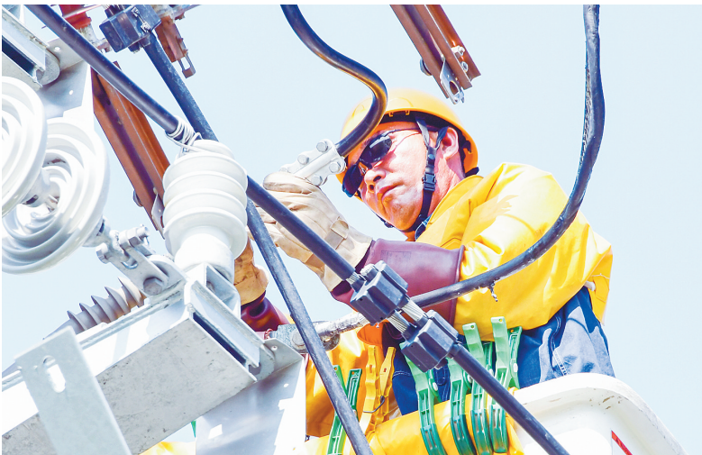
8月5日,舞阳县10千伏文城线10号杆1文城线电缆出现故障后,国网漯河电力公司抢修人员立即赶赴现场,持续抢修7个小时,做好电力供应。本报记者 杨光 摄
