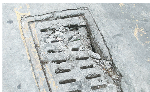
受降路与交通路交叉口向东约50米路南,井盖破损。
