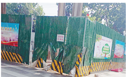
解放南路与万顺街交叉口,围挡破损。
