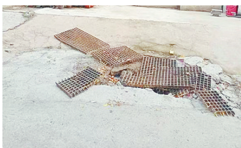
秀水河路与韶山北路交叉口向西约70米路南，路面塌陷。
