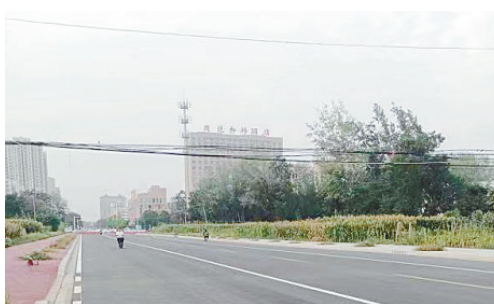
桐柏山路与黄河东路交叉口向南约70米，线缆低垂。
