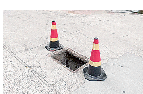
邙山路与辽河路交叉口向北约50米路西,井盖缺失。
