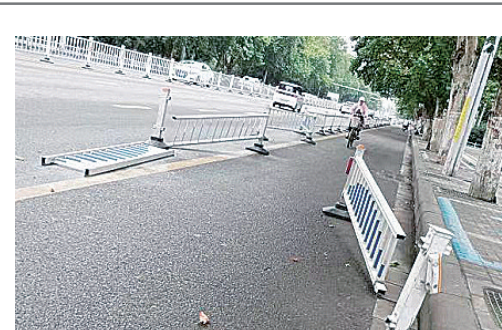
黄河路与邙山路交叉口向东约200米,交通护栏破损。
