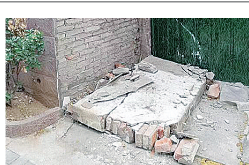
民主路与五一路交叉口向东约80米路北,专业修脚店东侧围墙倒地。
