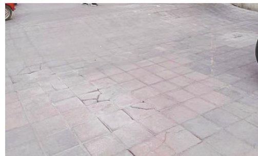
五一路与湘江西路交叉口东南角附近,人行道地砖破损。
