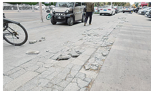
黄山路与岷江路交叉口附近,人行道地砖破损。
