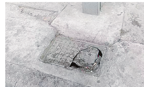
金山南路与湘江东路交叉口向南约120米路东,井盖破损。
