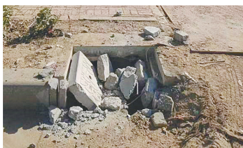
牡丹江路与解放北路交叉口向西约120米路南,井盖破损。
