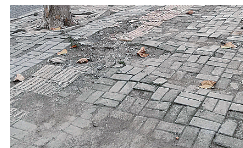
庐山路（黄河东路至渭河路段）人行道地砖破损。
