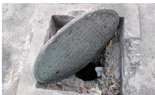
汇丰街与白云山南路交叉口向西约180米路北，井盖缺失。
