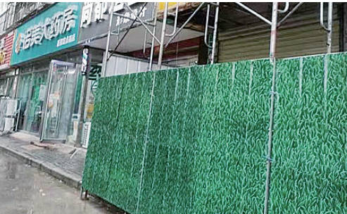
辽河路与太行山北路交叉口附近，施工围挡无占道审批公示牌。
