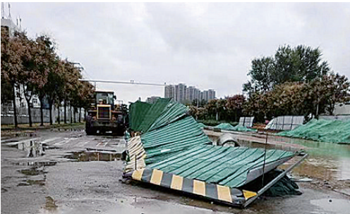
交通南路与银江路交叉口附近，围挡倒地。
