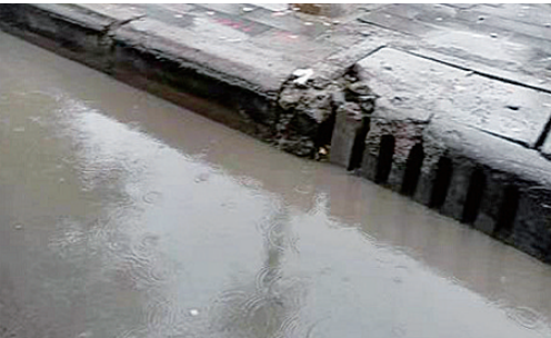
淞江路与白云山北路交叉口向西约400米路南，下水道堵塞。
