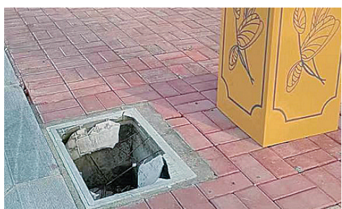
青龙山路与中山南路交叉口向东约60米路南，井盖破损。
