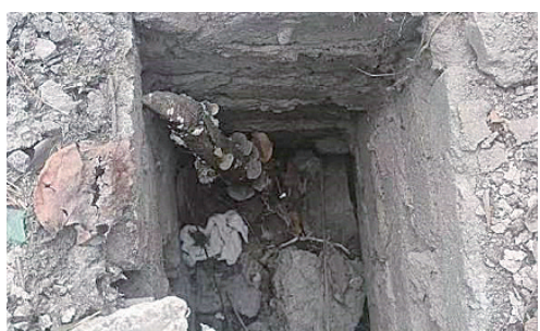
鹤云山路与柳江路交叉口向南约200米路东，井盖缺失。
