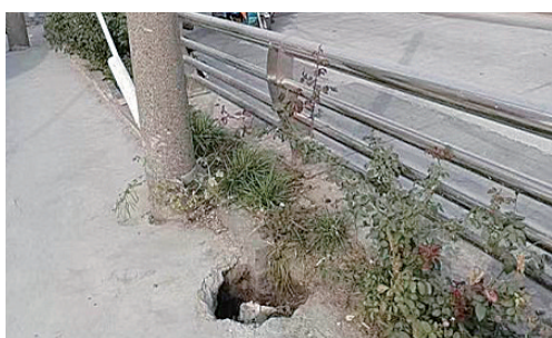
湘江路与团结路交叉口向东约20米路南，路面塌陷。
