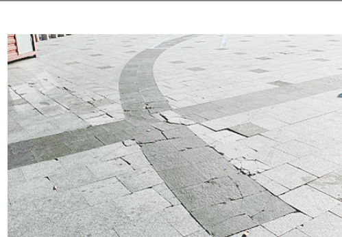
人民路与文化路交叉口附近,地砖破损。
