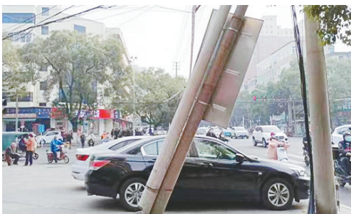
五一路与建设路交叉口向北约10米路东,线杆倾斜。
