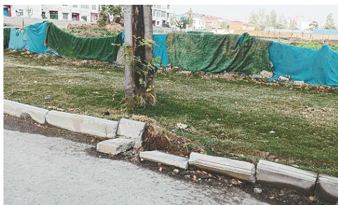
交通南路与银江路交叉口向北约15米路东,道边石破损。
