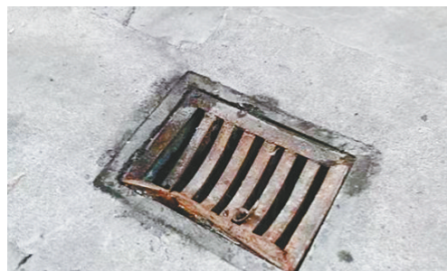
淞江路与井冈山北路交叉口向东约160米路南,雨水篦子下陷。
