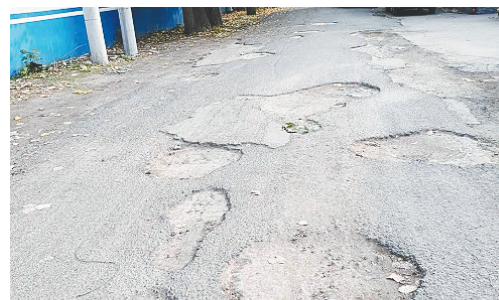
金江路与嵩山南路交叉口向东约100米路南,道路破损。
