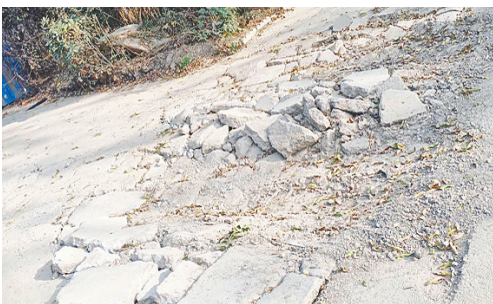
创业路与柳江路交叉口向北约150米路东，路面破损。
