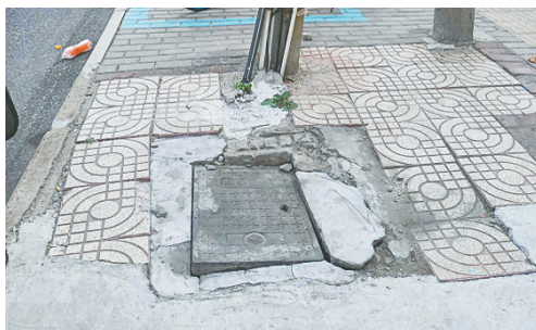
人民东路与中山南路交叉口向西约230米路南，井盖下陷。
