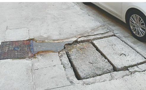
祁山路与会展路交叉口向南约30米路西，排水管道堵塞。
