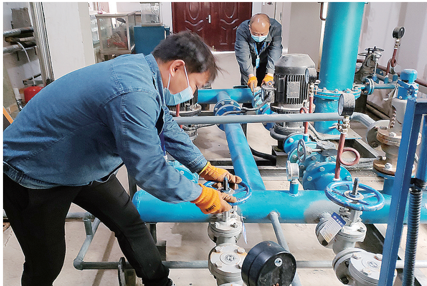
工作人员在漯河小学换热站调节补水泵阀门。
