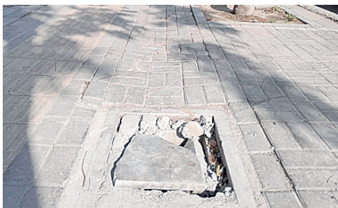
玉山路与汾河路交叉口向南约50米路西，井盖破损。
