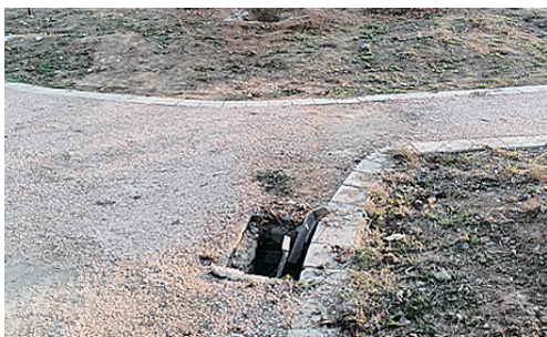
黄河东路与桐柏山路交叉口向西约120米路北，井盖缺失。
