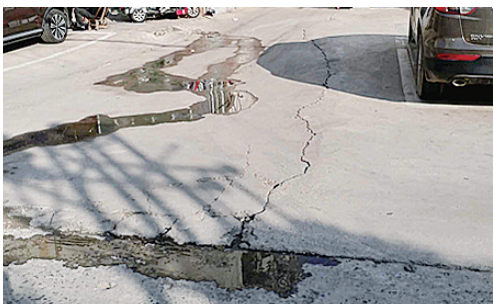
小南街与黄河西路交叉口向南约30米路东，下水道堵塞，污水外溢。
