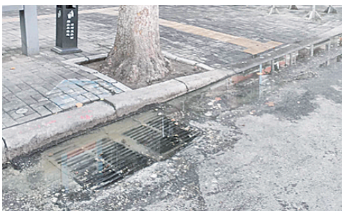
海河路与太行山北路交叉口向西约120米路南，下水道堵塞。
