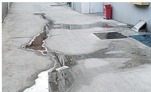
交通南路与建设路交叉口向北约180米路东，下水道堵塞，污水外溢。
