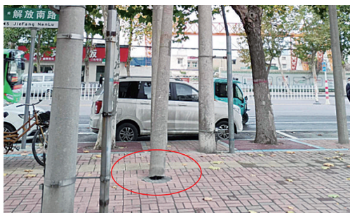
解放南路与永康路交叉口附近，线杆底部断裂，存在安全隐患。
