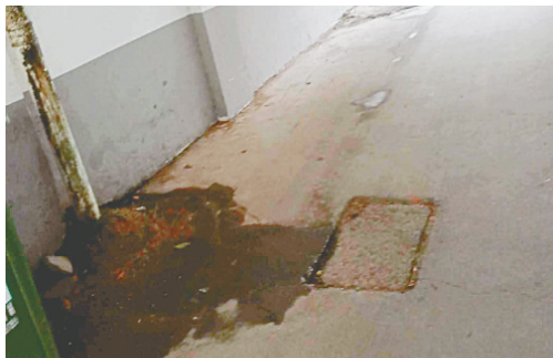
金华小区，下水道堵塞，污水外溢。
