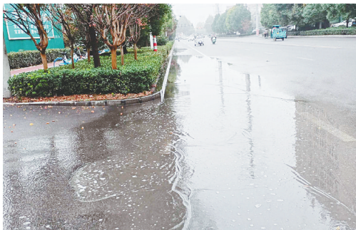
柳江路和白云山路交叉口向西约100米路北，下水道堵塞，路面积水。
