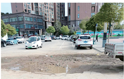
沙北路与崂山路交叉口向西约20米，路面破损。
