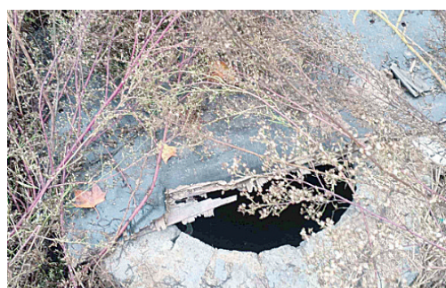
燕山路与洋河路交叉口向北约200米路东，井盖缺失。
