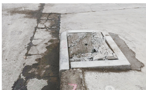
白云山北路与尧河路交叉口向南约1米路西,井盖破损。
