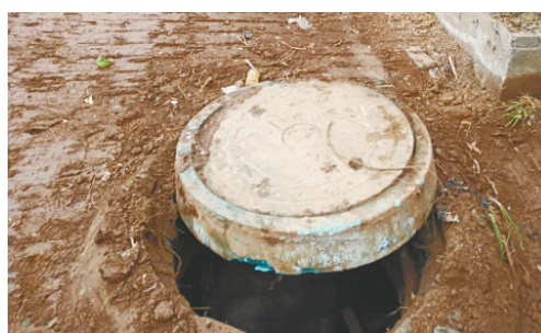
庐山路与人民东路交叉口向北约210米路东,井盖移位。
