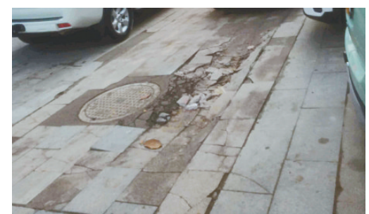
嫩江路与黄山路交叉口向西约60米路南,地砖破损。
