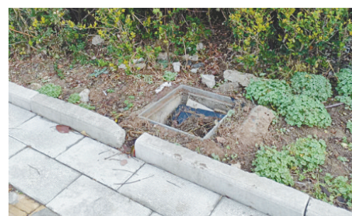
丹霞山路与桂江路交叉口向北约5米路东,井盖缺失。
