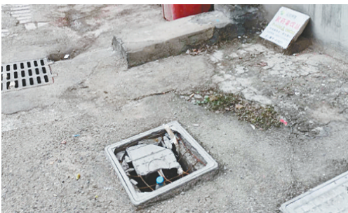
文景北巷与人民西路交叉口向南约10米路西，井盖破损。
