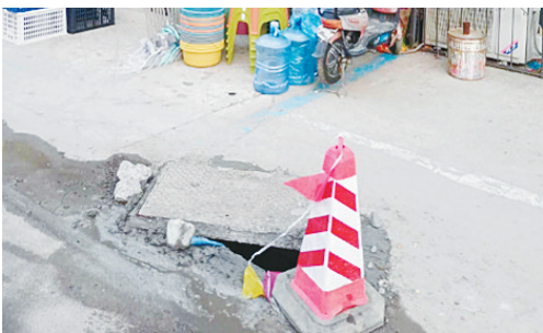
华山路与辽河路交叉口向南约20米路东，井盖移位。
