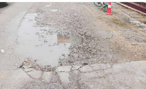
黄河中路与祁山路交叉口向东约40米路南，路面破损。
