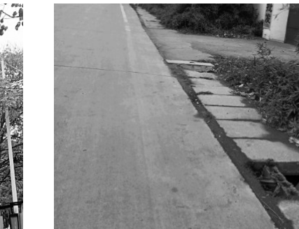
渭河路与桐柏山路交叉口向西约200米路北，沟槽盖板破损。
