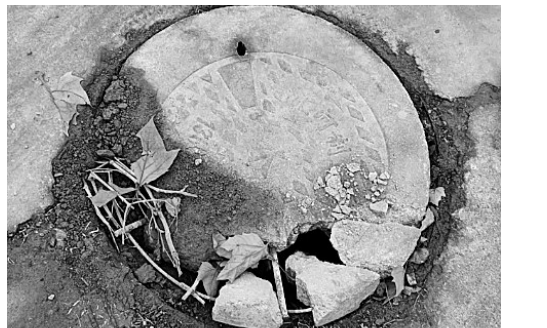
桂江路与鹤云山路交叉口向西约60米路南，井盖破损。
