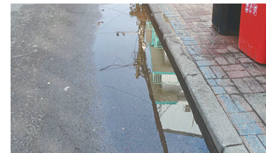
马路街与五一路交叉口向东约50米路北,排水管道堵塞。
