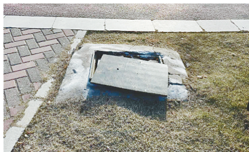
沙北路与黄山路交叉口向东约60米路南,井盖移位。
