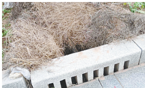
渭河路与中山北路交叉口向东约200米路北,井盖缺失。
