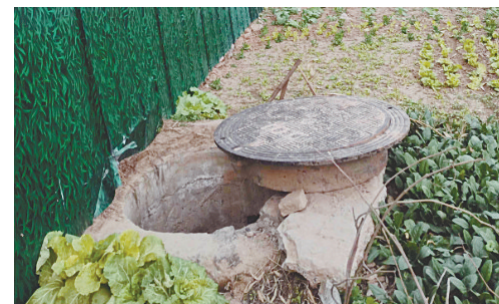
渭河路与中山北路交叉口向东约200米路北,井盖移位。
