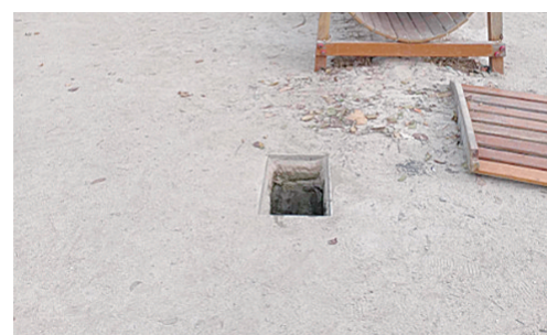
黄河东路与桐柏路交叉口向西约200米路北,井盖缺失。
