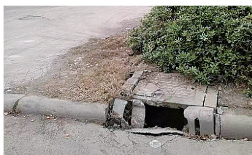
人民东路与庐山路交叉口向西约60米路北,雨水篦子破损。
