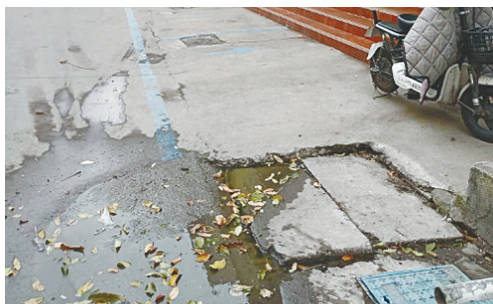
环城路与京华路交叉口向西约60米路北，下水道堵塞，污水外溢。
