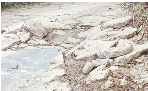
创业路与柳江路交叉口向北约150米路东，道路破损。
