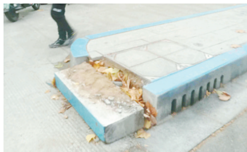
香山路与湘北支路交叉口向北约20米路西，道边石倾倒。
