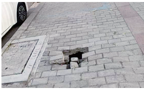
太行山南路与柳江路交叉口向北约40米路东,人行道路面塌陷。
