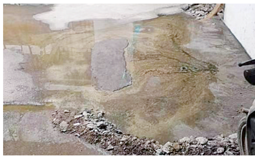
勤俭巷与交通南路交叉口向西约80米路北,排水管道堵塞。
