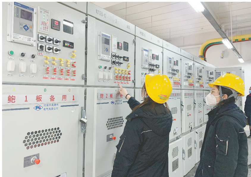
国网漯河供电公司变电运维中心英章运维班工作人员对110千伏鲍庄变电站进行检测和调试。 本报记者 刘净涛 摄
