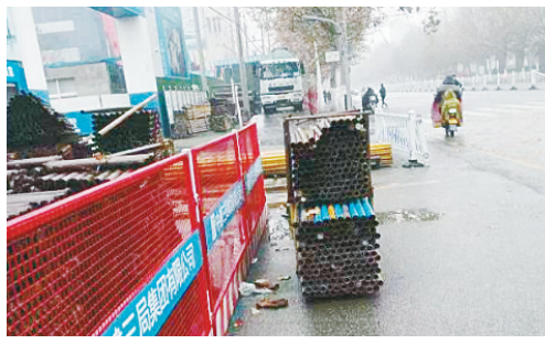
人民东路与衡山路交叉口向西约60米路南,人行道上,施工物料乱堆乱放。
