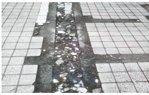
嵩山东支路与嫩江路交叉口附近,多处地砖破损、缺失。
