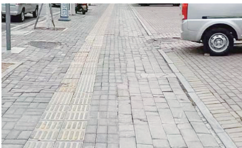
玉山路与汾河路交叉口向南约20米路西，人行道地砖破损。
