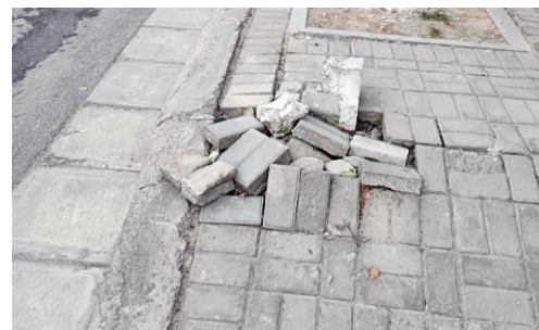
白云山北路与岷江路交叉口向南约60米路东，人行道地砖破损。
