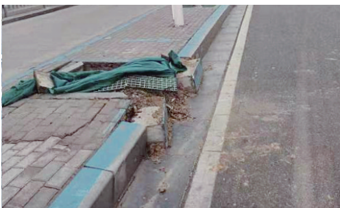
人民西路与五一路交叉口向东约120米路北，道边石移位。
