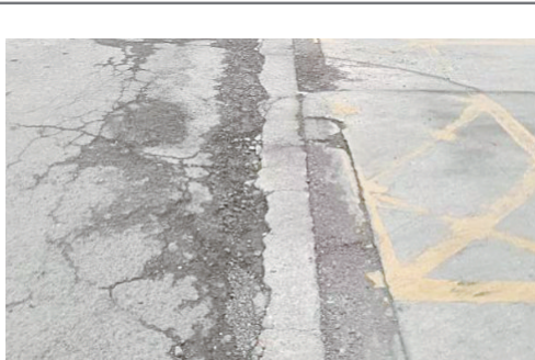
漓江路与金山南路交叉口向东约130米路北，路面破损。
