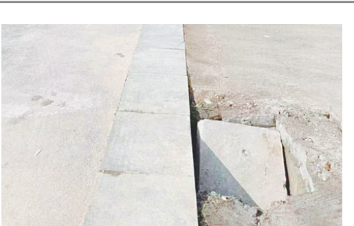
漓江路与庐山路交叉口向东约150米路北，井盖下陷。
