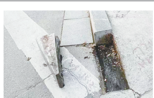
黄河中路与解放北路交叉口东北角，道边石移位。
