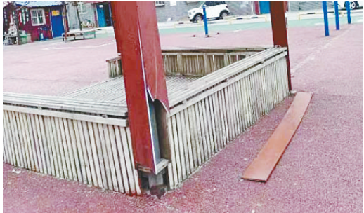
柳江路与太行山南路交叉口向东南约20米路北,水景新苑小区休息亭损坏。
