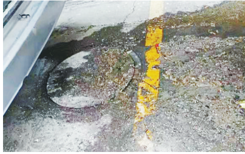
湘江西路与泰山南路交叉口向东南约80米路南,排水管道堵塞,污水外溢。
