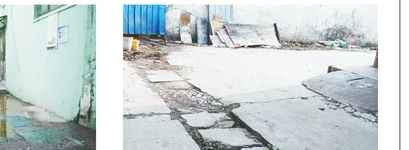
峨眉山路69号院内多处排水管道盖板破损、下陷。
