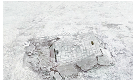
韶山南路与湘江东路交叉口向北约80米路西，井盖破损。
