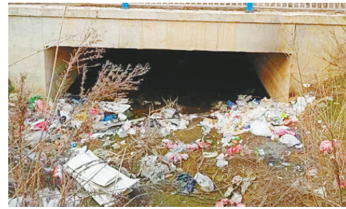
牡丹江路与解放北路交叉口向西约300米路南，垃圾无人清理。
