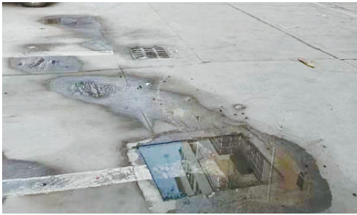
千山路与淞江路交叉口向北约100米路西，下水道堵塞，污水外溢。
