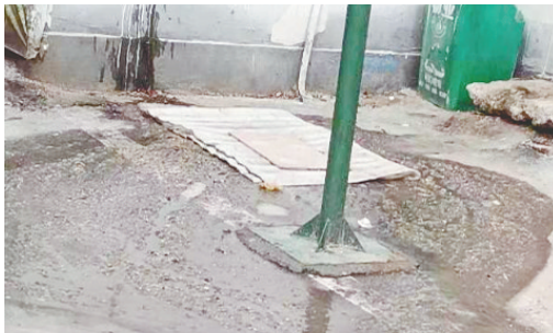
文化路与建新路交叉口向北约40米路西，下水道堵塞，污水外溢。
