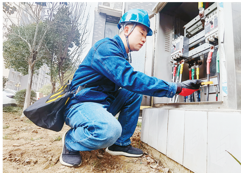
三月六日,张彬在螺湾小镇小区检查低压分支箱。
