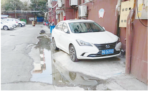
纺织厂家属院13号楼北侧，排水管道堵塞，污水外溢。
