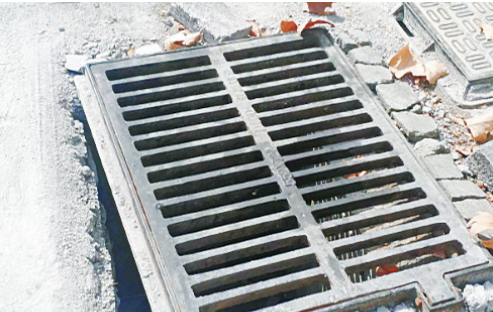
华山路与海河路交叉口向北约20米路西，雨水篦子周边破损。
