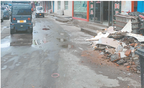
华山路与海河路交叉口向南约20米路西，门面房前有建筑垃圾。
