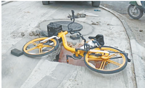
大街街与南后街交叉口向南约40米路西，井盖缺失。
