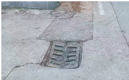
湘江西路与太行山南路交叉口向东约100米路北,雨水篦子破损。
