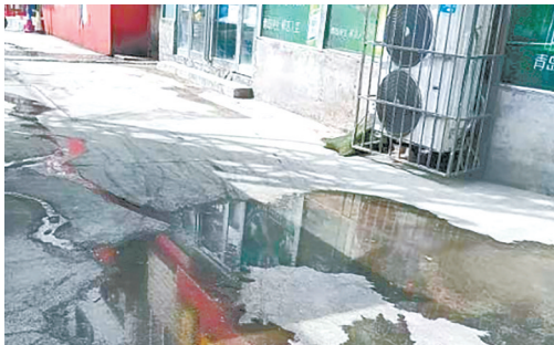
岷山路与阮庄路交叉口向南约10米路西,排水管道堵塞,污水外溢。
