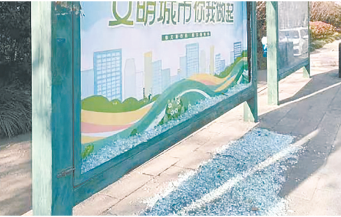
桂江路与王屋山路交叉口向西约150米路北,公交车停靠点玻璃破损。
