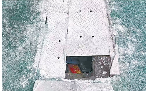
交通南路与人民西路交叉口向北约30米路东,污水盖板破损。
