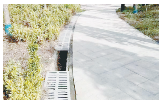
东山东路与黄河东路交叉口向北约60米路东，雨水篦子缺失，有安全隐患。
