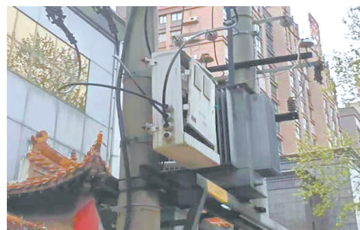
湘江西路与太行山南路交叉口向西约150米路南，电力设施箱门破损。
