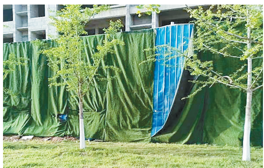
丹江路与宝塔山路交叉口向西约90米路北，围挡上绿网破损。
