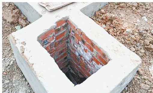
翠华山路与月湾湖西路交叉口向北约200米路西，井盖缺失。
