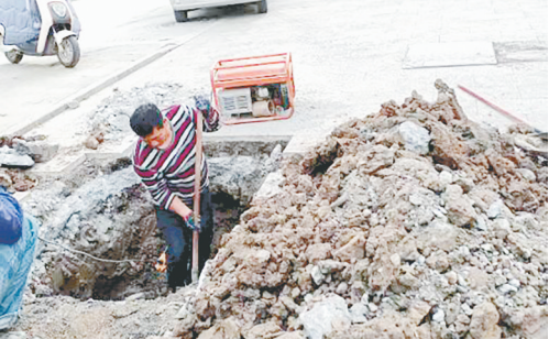
汉江路与太白山中路交叉口向西约80米路南，疑似有人无证掘路。
