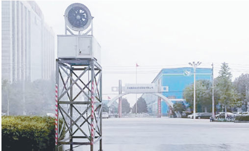
中山南路与人民东路交叉口向南约100米路西，喷雾降尘设备漏水。
