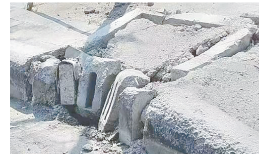
淞江路与白云山路交叉口向西400米路南,雨水篦子破损。
