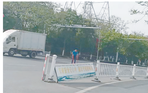
嵩山南路与大学路交叉口向北约10米路东,交通护栏损坏。
