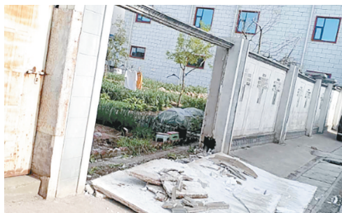
京广路与银江街交叉口向北约150米路东，墙体破损。
