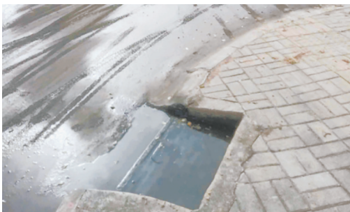
龙江西路与漯李路交叉路口附近，排水管道堵塞。
