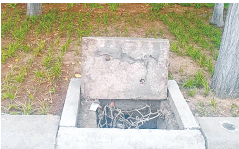
金山北路与牡丹江路交叉口附近，绿化带内雨水井盖打开，存在安全隐患。
