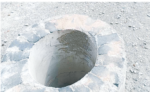
黄河西路与白云山路交叉口附近，多个不明井盖缺失，存在安全隐患。
