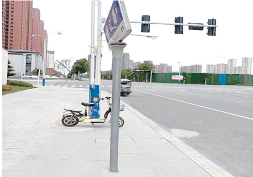
岷江路与黄山路交叉口向西约30米路北，人行道上路名牌损坏。
