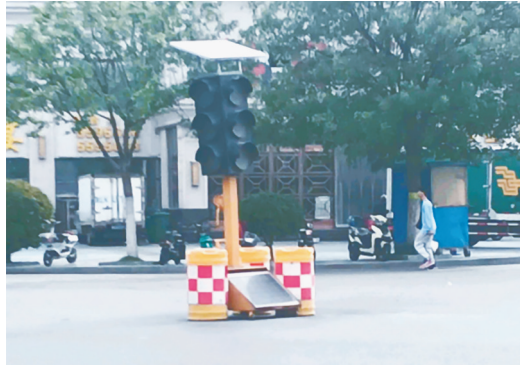
燕山北路与深河路交叉口路口中间，交通信号灯不亮。
