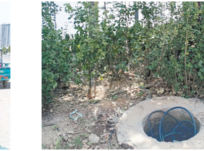
燕山北路与淞江路交叉口附近,绿化带后面的通信井盖缺失。
