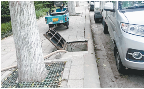
黄河东路与韶山北路交叉口向西约100米,人行道上雨水井盖移位,存在安全隐患。
