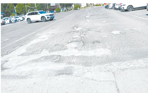
岷江路与井冈山北路交叉口东侧,道路破损。
