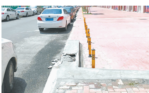
柳江路与文化路交叉口向西约120米路南,盖板破损。
