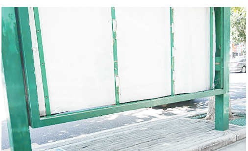
人民东路与泰丰西巷交叉向西约20米路北,公交站亭的玻璃缺失。
