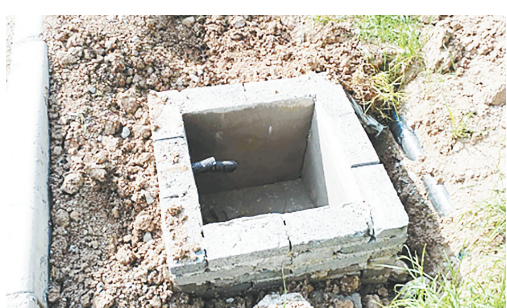
湘江西路与杏王山路交叉向东约60米路北,井盖缺失,存在安全隐患。
