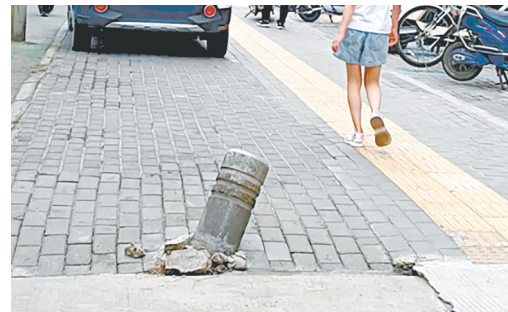
泰山北路与洪河路交叉口向北约60米路东,便道柱底部损坏。
