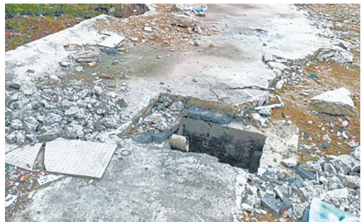
龙江西路与金山北路交叉向西约100米路北,人行道北侧井盖缺失,存在安全隐患。
