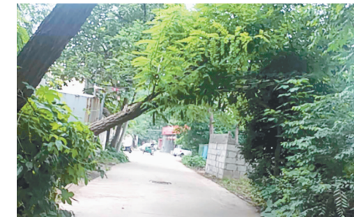
庐山路与湘江路交叉口向南约80米路东,道路旁树木倾斜,存在安全隐患。
