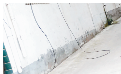
黄河东路与燕山北路交叉口向东约150米路南，线缆低垂拖地。
