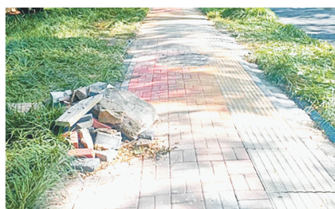
天山路与淮河路交叉口向南约40米路西，人行道上施工后未清理场地。
