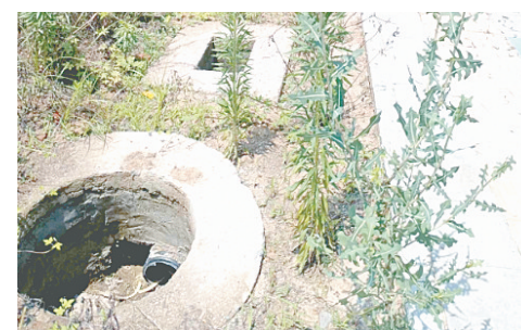
金山北路与龙江西路交叉口向南约300米路东，人行道旁多个井盖缺失。
