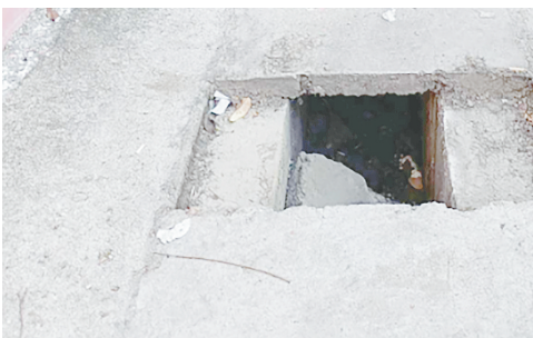
金江路与五一路交叉口向西约30米路北，沟槽盖板破损。
