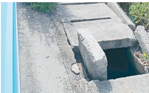
龙江东路与东北路交叉口向东约40米路南，污水盖板移位。
