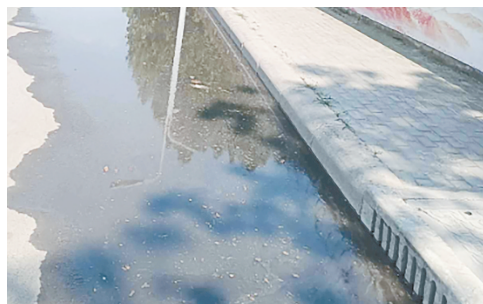
龙江西路与解放北路交叉口向东约30米路南，辅道上排水管道堵塞。
