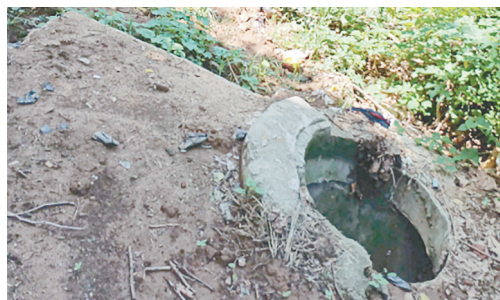
太白山中路与汪河路交叉口向南约20米路西，井盖缺失。
